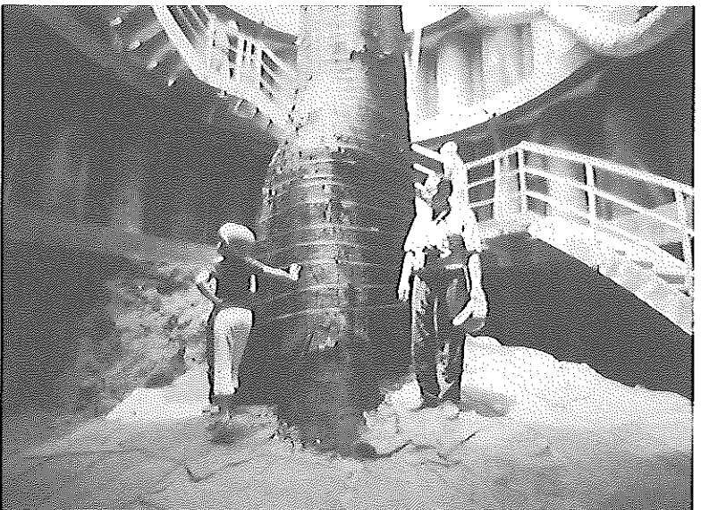
写真4.1.1-28 A-5根元部の状況 (一部盛り上がったような部分が見られた)
